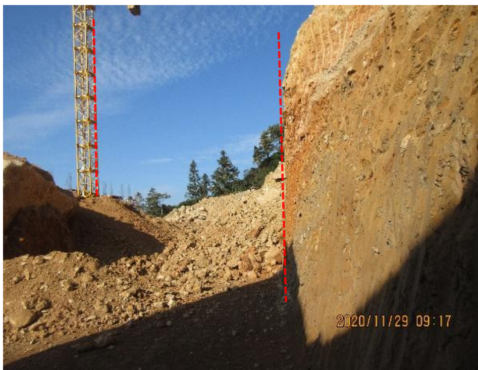
图 4 坍塌区域东侧边坡坡度对比情况
