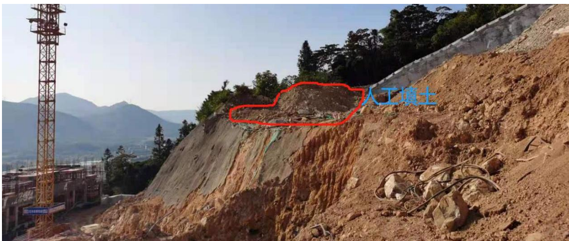
图 5 坍塌区域上方人工填土状况
