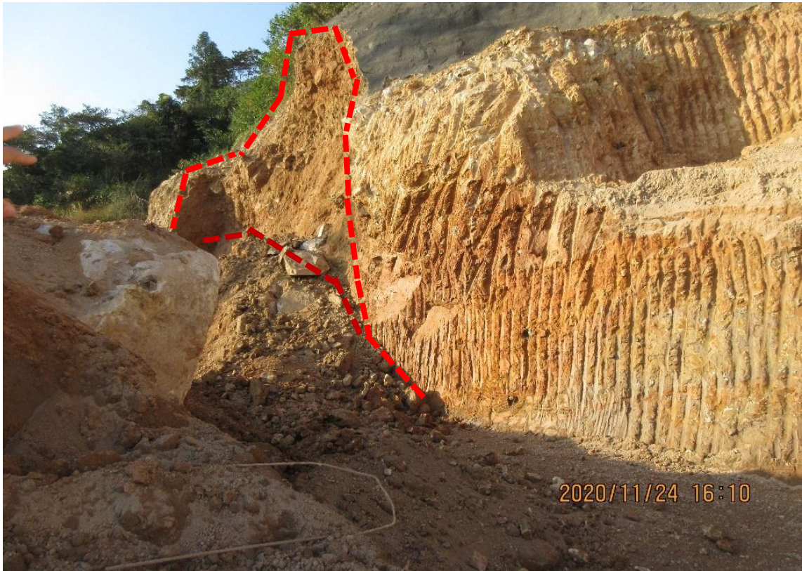
图 17 事故坍塌全貌
